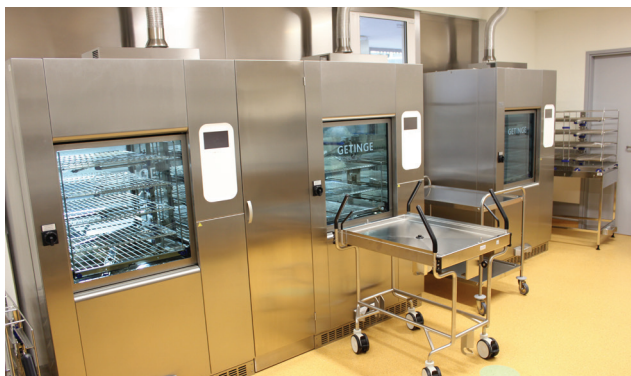
Slika: Centralna sterilizacija – nečista cona – prehodni termodezinfektorji
